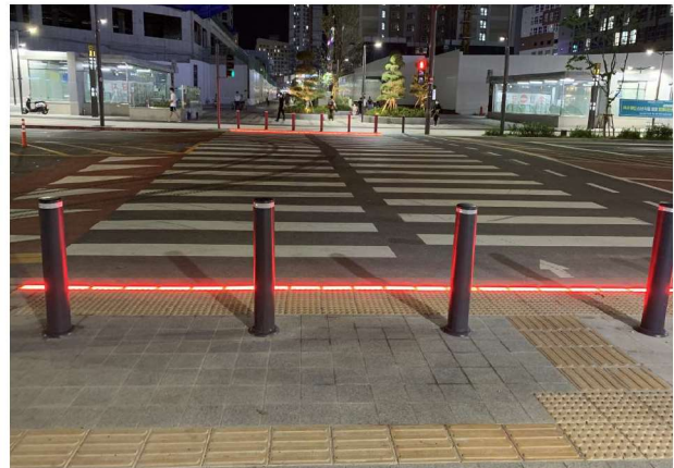
LED 바닥 신호등 (시민의 안전한 보행 환경 조성을 위해 미사역 앞과 창우초교 교차로 2개소에 LED 바닥신호등 시범 설치운영)
